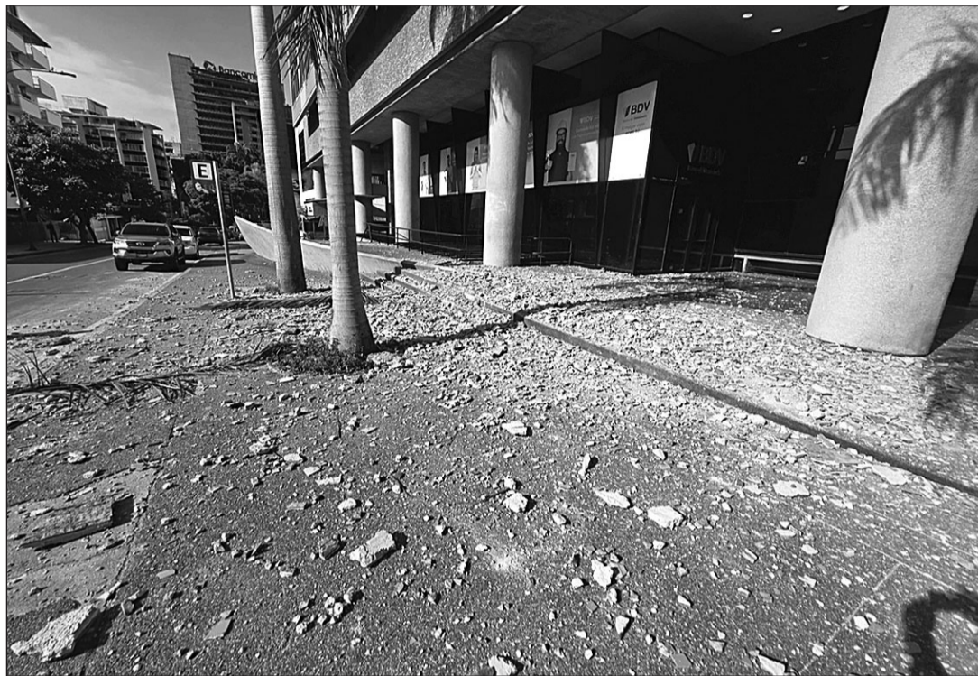
Cascotes caídos de la fachada donde funciona la sede del Consulado General de España en Caracas.
